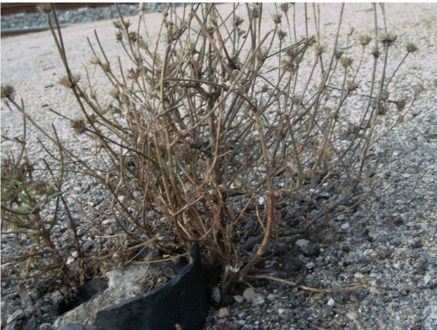
Bildtext 7: Abgestorbene und vertrocknete Pflanze im Asphaltbodenbelag des Bahnsteiges
